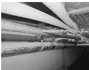
～漏水の原因となるピンホール～
